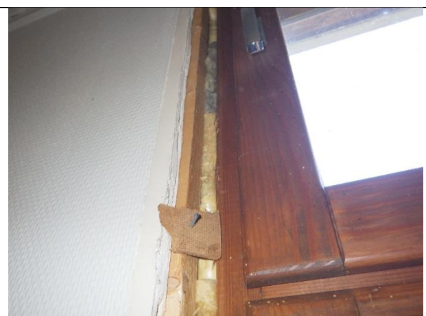
Kuva 49 – Karmin ja ikkunan välissä uretaani
