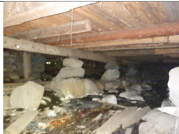
Kuva 26 – Ryömintätilan pohjalla olevaa rakennusjätettä.
