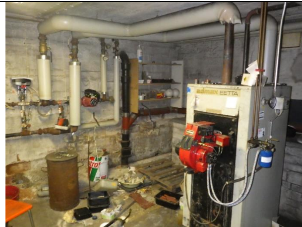
Kuva 31 - Yleiskuva kellarin teknisestä tilasta
