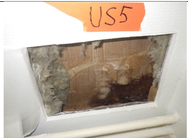
Kuva 45 – Yleiskuva, rakenteen sisällä kosteusvauriojälkeä, [US5]
