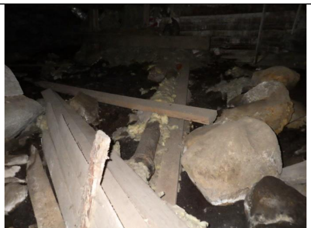
Kuva 23 – Ryömintätilan pohjalla olevaa rakennusjätettä
