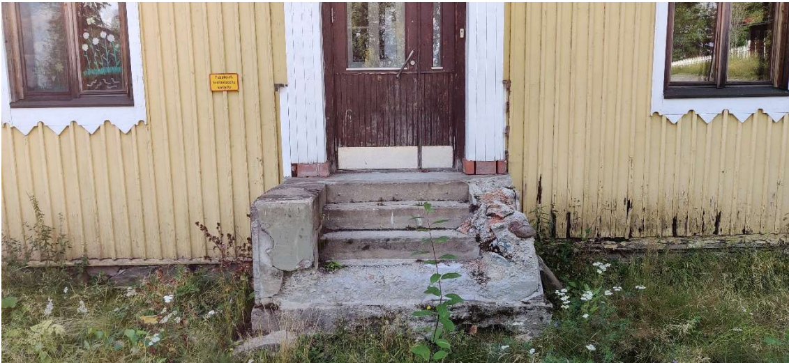
Kuva 13. Julkisivulaudoitus on etenkin alareunoistaan huonossa kunnossa. Portaat ovat huonossa kunnossa ja ulko- ovet teknisen käyttökänsä lopussa.
