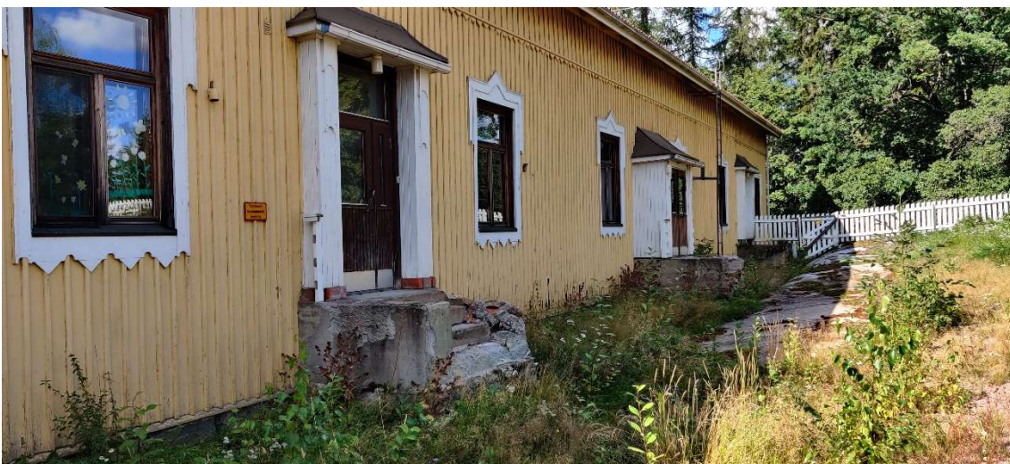
Kuva 9. Ulkoportaat ovat huonossa kunnossa ja maanpinta on kallistunut rakennusta kohti. Rakennuksen edustalla näkyvässä kallionpintaa.
