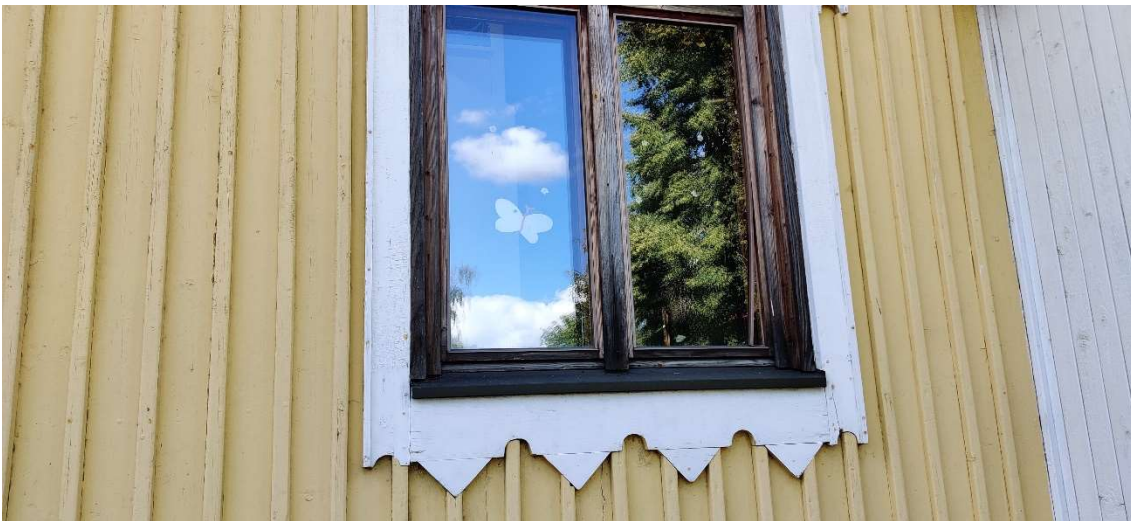
Kuva 14. Ikkunoiden ulkopuutteet ja karmit vaativat huoltoa.
