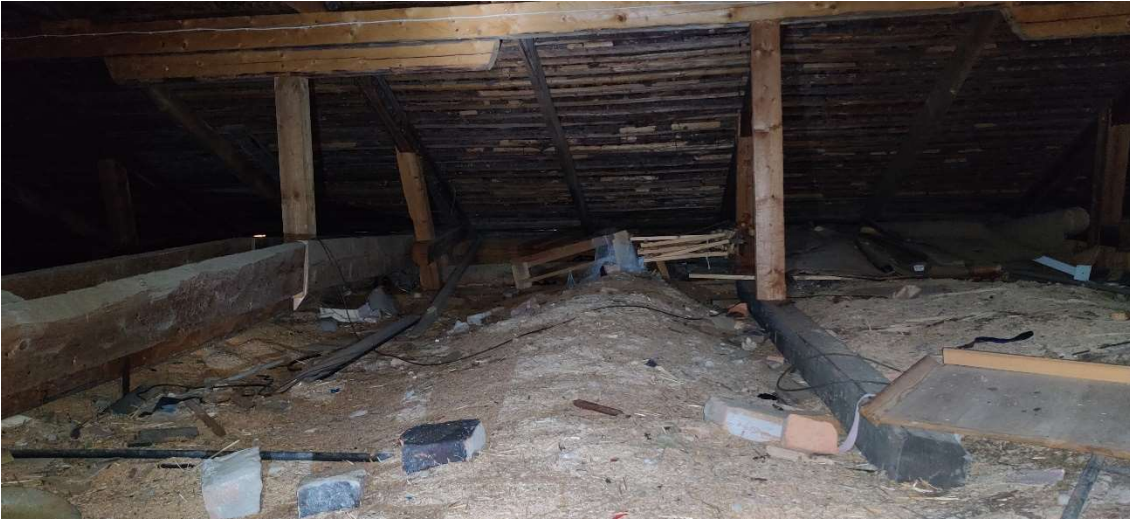
Kuva 22. Muualla ullakkotila on kylmää tilaa ja eristeet ovat keskiosalla näkyvissä. Vesikatteen alla ei ole aluskatetta.
