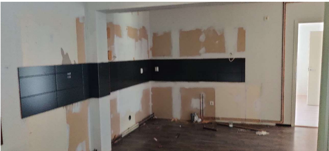
Kuva 18. Keittiöpisteet on purettu.
