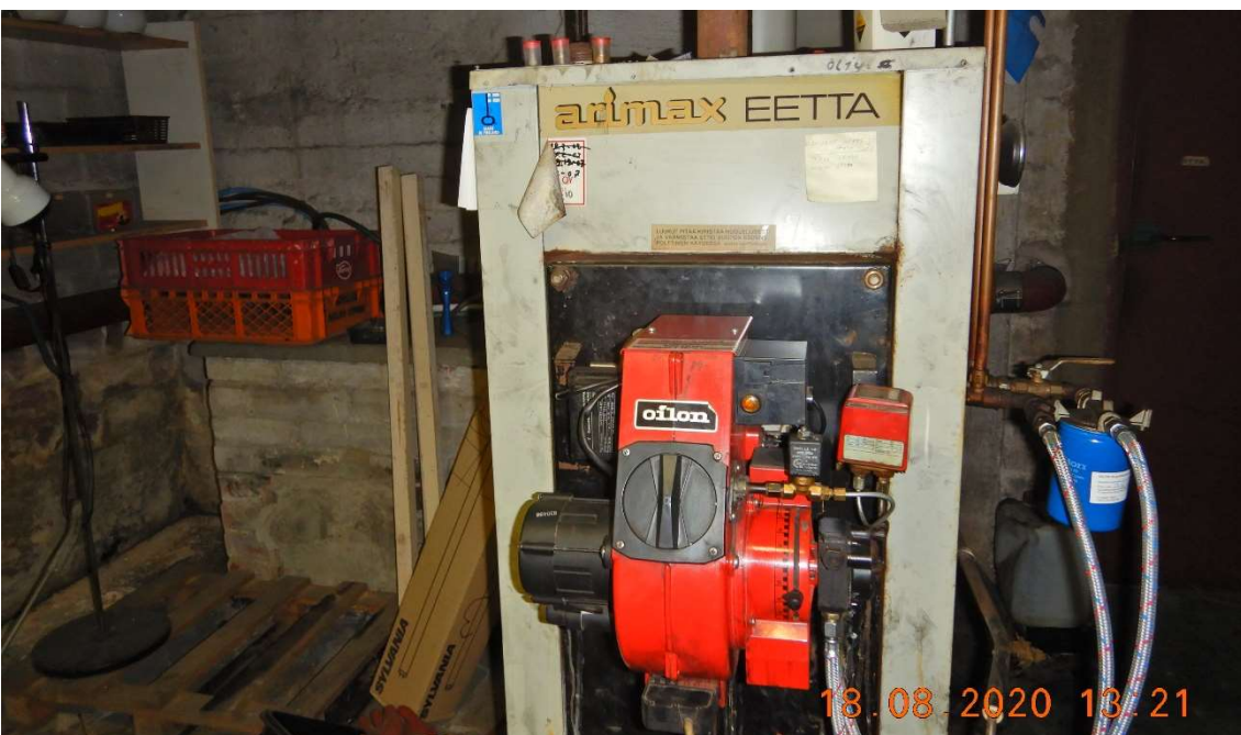
Kuva 12. Kellarissa on öljykattila ja öljysäiliöt.
