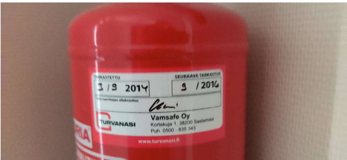
Kuva 26. Vaahtosammuttimet on tarkistettu viimeksi vuonna 2014.
