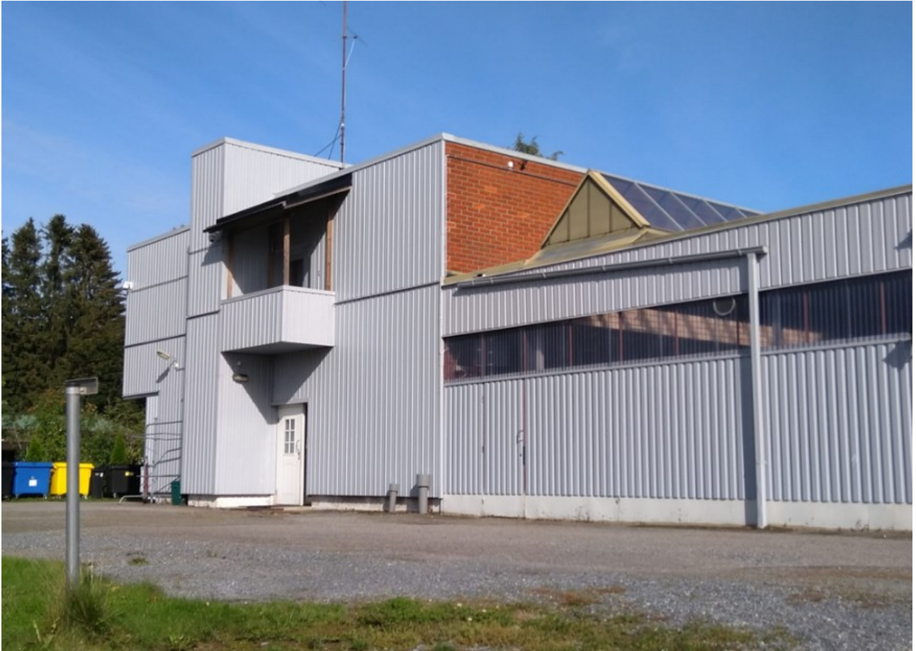
Kuva 5: Rapautunutta julkisivutiiltä on korvattu pellillä rakennuksen eteläseinustalta. Rakennuslupa muutokselle on saatu 2007.
