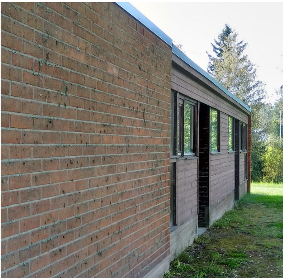
Kuva 12: Julkisivuissa kasvaa jäkälää ja tiilet ovat useassa kohtaa rapautuneet.
