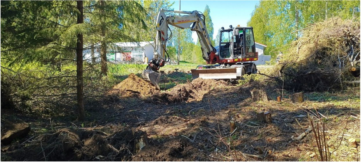
Kuva 24. Koekuoppaa nro 4 kaivetaan. Kuvassa edustalla koekuopan nro 5 kohta. Kuva luoteeseen. Kuva: Johanna Rahtola, Maanala Oy.
