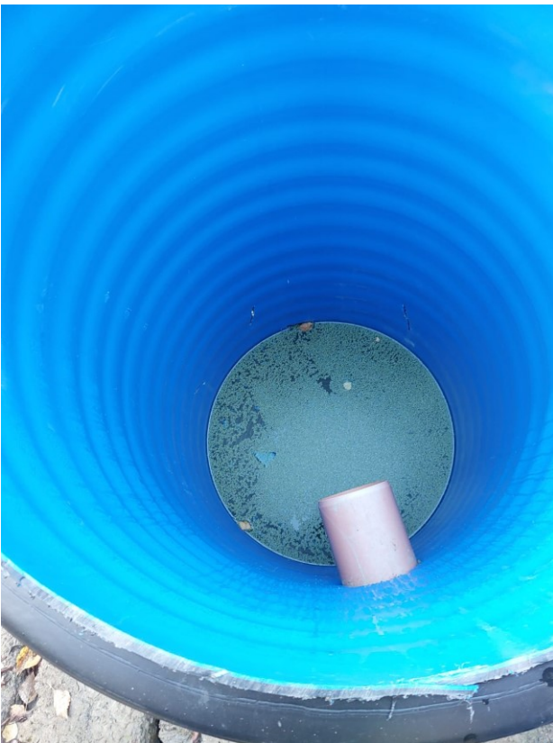
Kuva 9. Sisäpuolisten vesien hallinta; tarkastuskaivo
