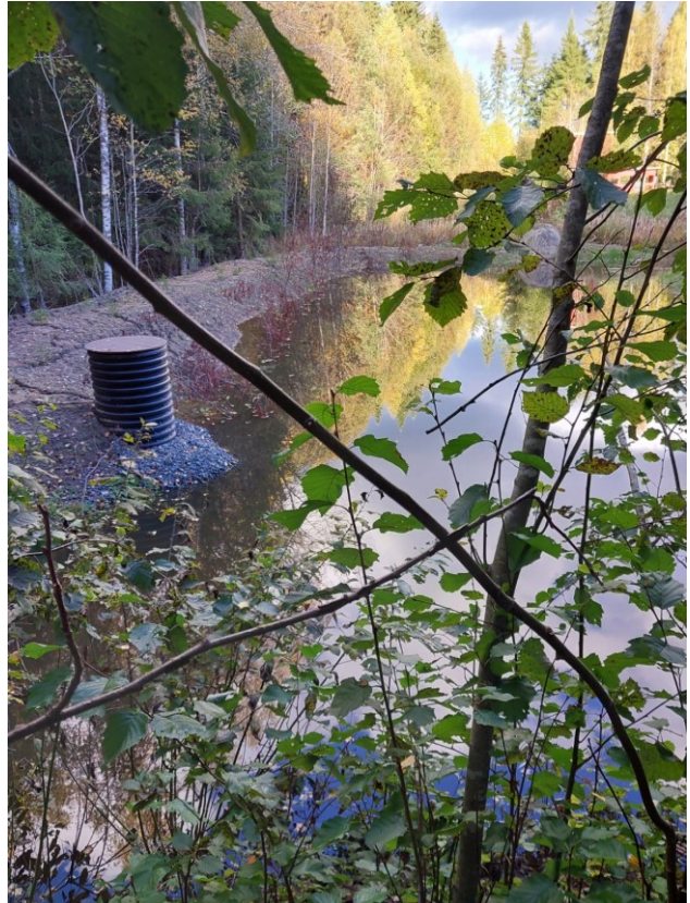
Kuva 4. Sisäpuolisten vesien hallinta; haihdutusallas ja tarkastuskaivo
